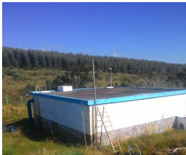
Figura 07 - Reservatório C2 - Três Bocas
