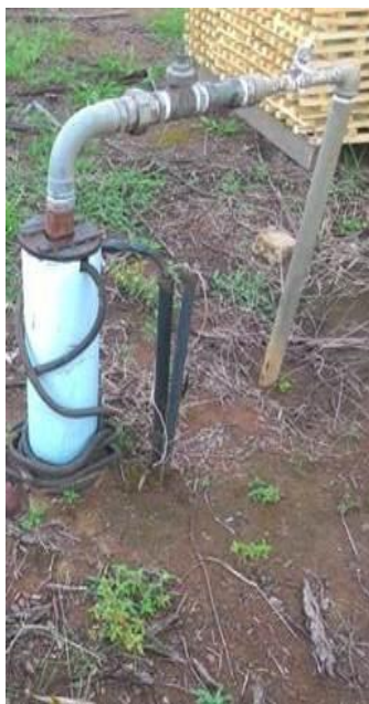
Figura 04 - Captação em poço profundo - Distrito Industrial II
