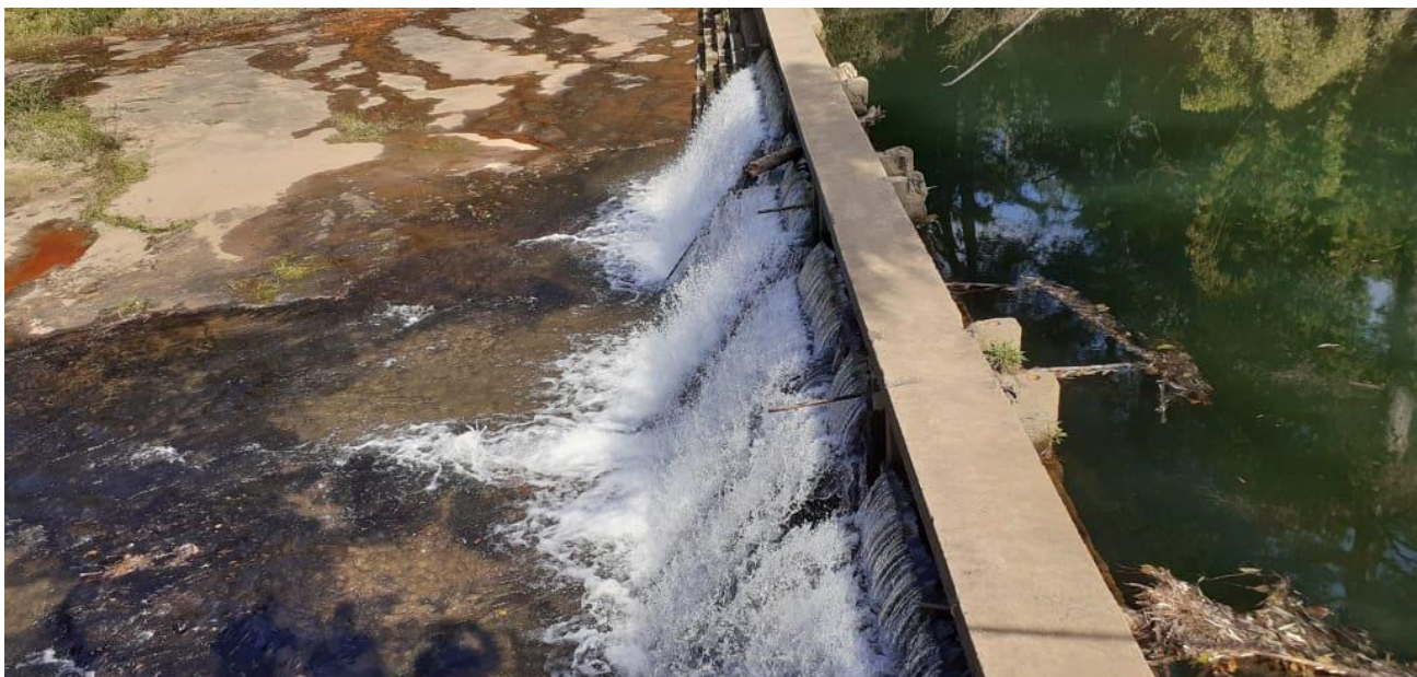
Figura 01 – Barragem Captação Rio Capivari
