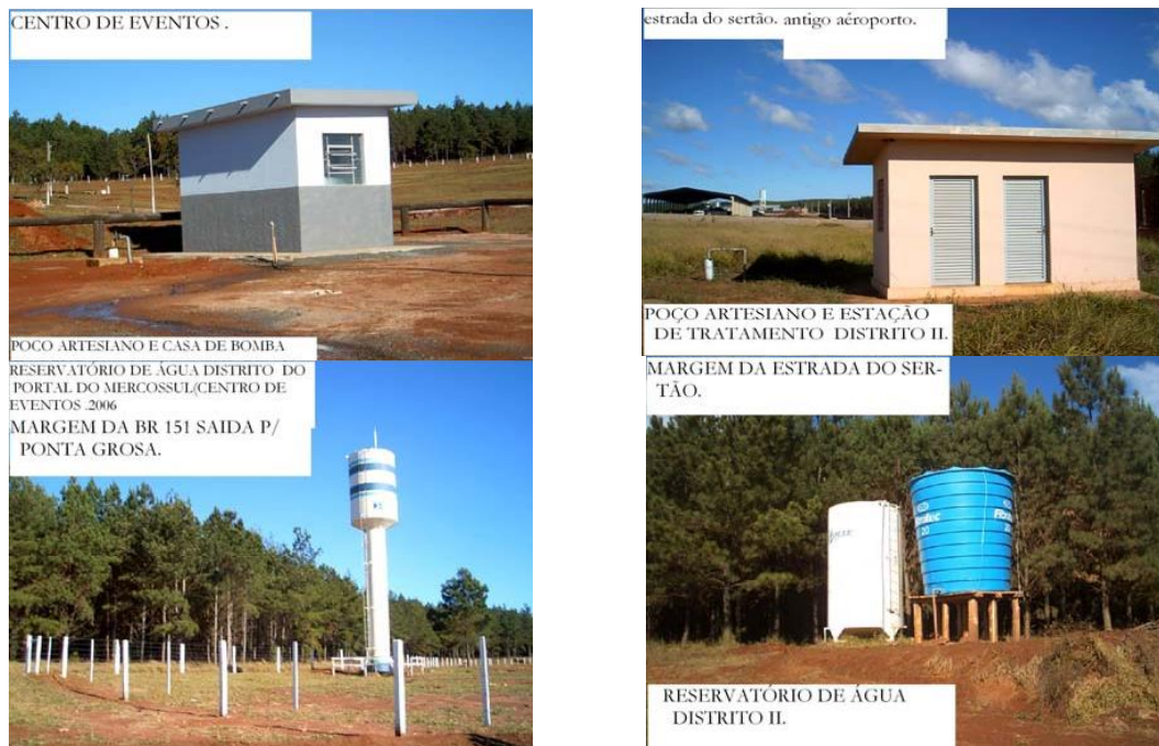
Figura 5 – Poços de captação tubular profundo reservatórios da SAMAE. Fonte: Prefeitura Municipal de Jaguariáiva.
